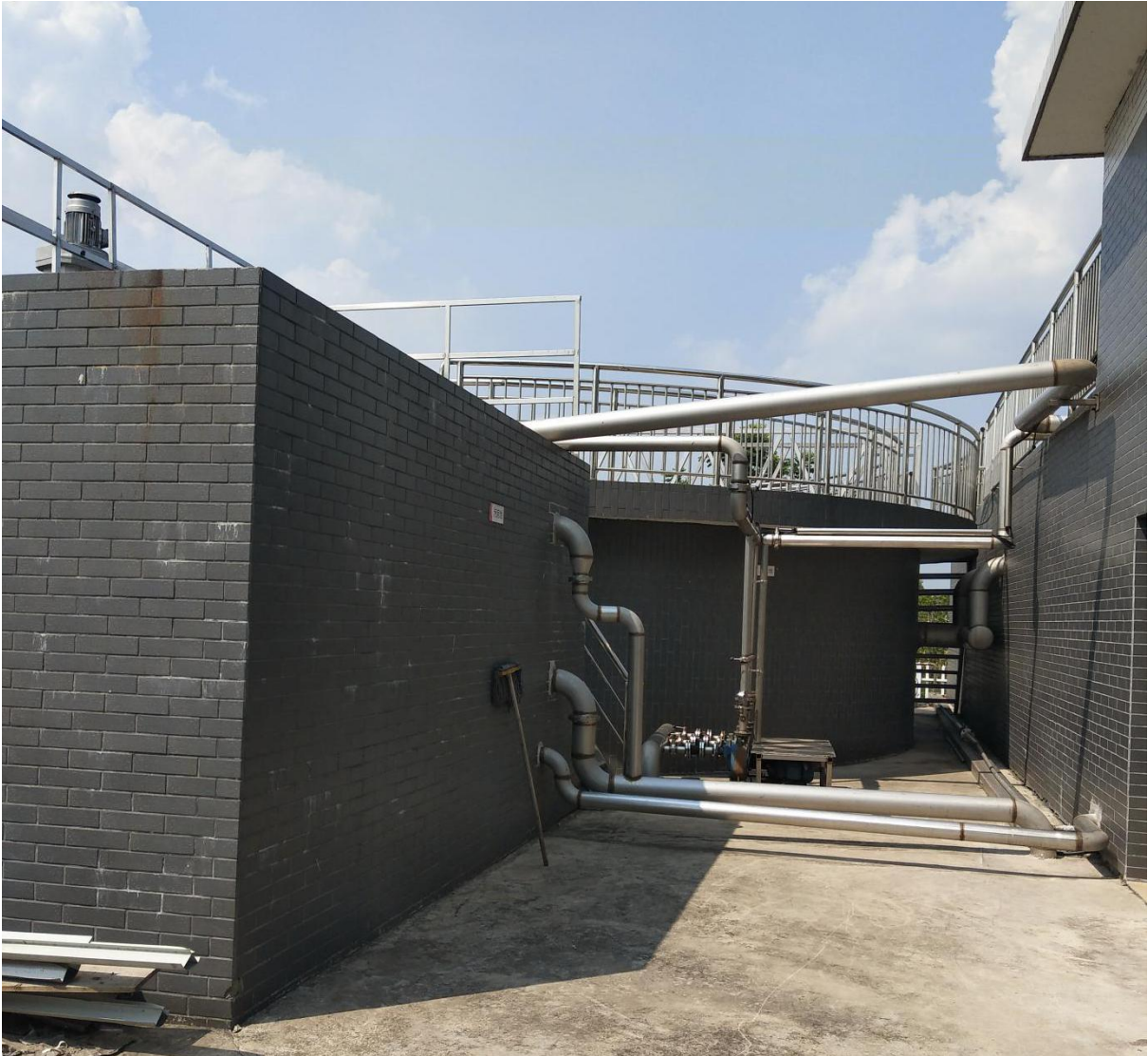
图 4-2 废水治理设施图片
